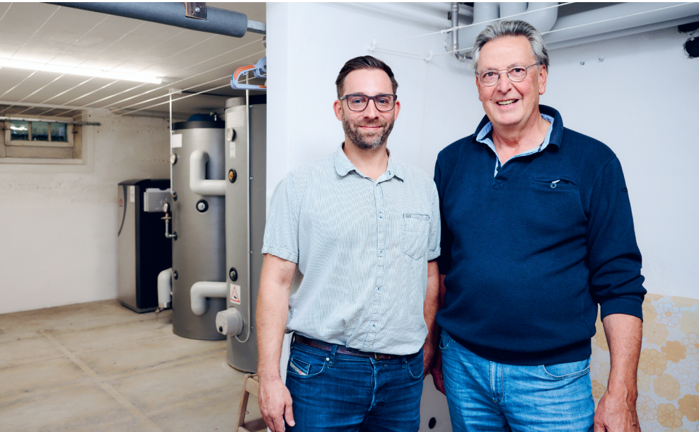
STWEG Vertreter Beat Guggisberg (rechts) und Reto Trittibach, Leiter Energieberatung der Stadt Bern, vor der neuen Erdsonden-Wärmepumpe. Bild: M. Friederich
